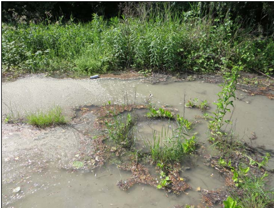
Schachtdeckel mit Wasseraustritt am 04.06.2013
